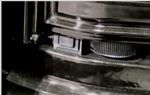
Fan Override Switch
